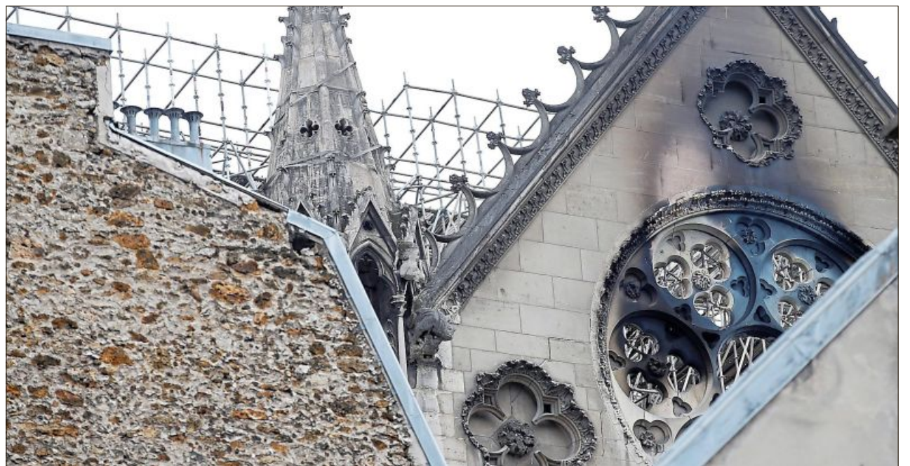
VERWÜSTETE KATHEDRALE: Nach dem Inferno von Notre-Dame in Paris sind die Flammen gelöscht. Vor dem avisierten Wiederaufbau steht die Frage: Wie groß sind die Schäden? In Ostbayern prüfen Feuerwehren und Bauämter derweil die eigenen Sicherheitsvorkehrungen. Foto: dpa
